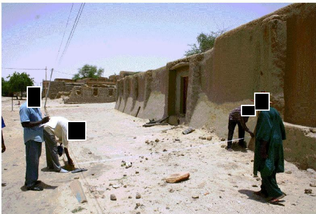
Mausolée de Cheikh Sidi Mahamane al Foullani et Mausolée de Cheikh Sidi Baber Baba Idjé, vérification des fondations et des dimensions, photo : [redacted] 2014
