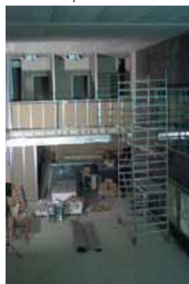
Construction de la salle d'audience et du centre de presse en 2003 © ICC-CPI
